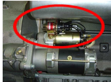
Área sin la placa deflectora de calor
